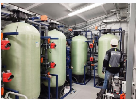
Комплекс блочно-модульный водоподготовки ВОС-200-2-ХЛ1 БСО-2
