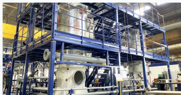
Установка подготовки газа УПГ- 02-57000 -4,0-ХЛ1
