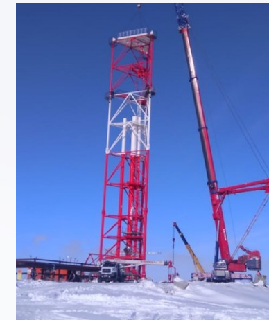
Совмещенная факельная установка с принудительной подачей воздуха
