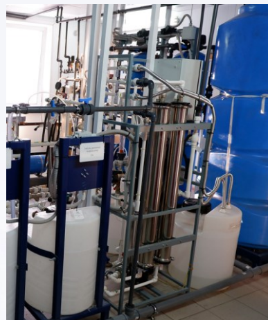
Установка подготовки питьевой воды ВЗИС Приобского и Южного месторождения
