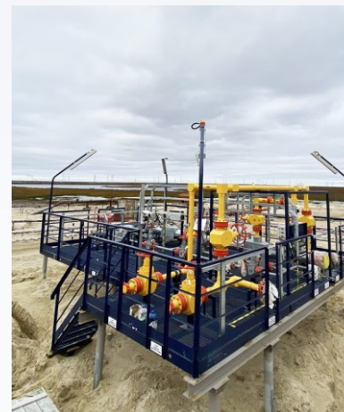
Блоки отсечной арматуры
